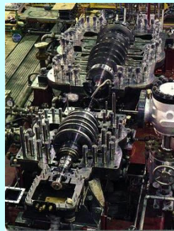
圧縮機・発電タービン
